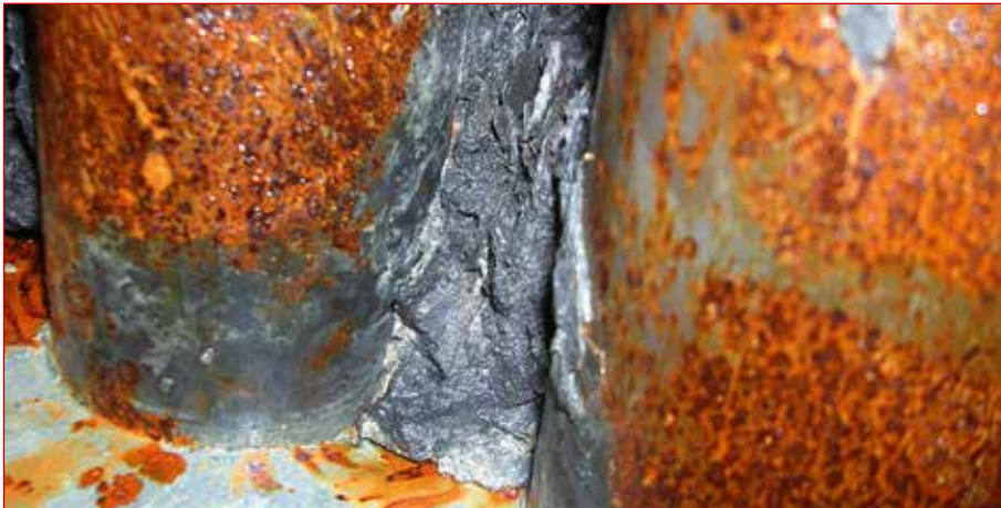
Abbildung Rauchgasrohre: Auswirkungen von mangelhafter Heiznetzwasserqualität in einem Wärmeerzeuger: Erosion, Korrosion und Ablagerungen von Kalk und Magnetit.
