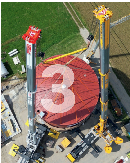
Ein Baustein der Energiewende: Der 6.000-m 3 -Energiespeicher in Leutkirch schafft die Grundlage für eine zuverlässige und nachhaltige Wärmeversorgung
